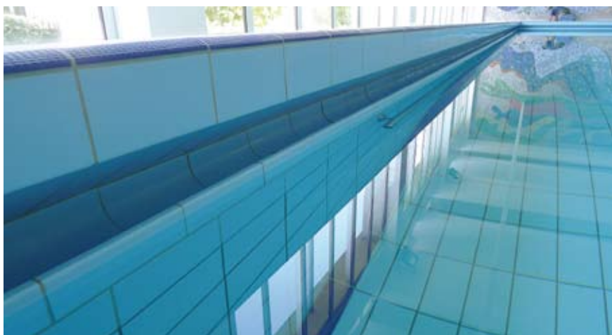
◆ RYNNA TYPU WIESBADEN DOLNY, GÓRNOŚLĄSKIE CENTRUM REHABILITACJI REPTY IM. GEN. JERZEGO ZIĘTKA
